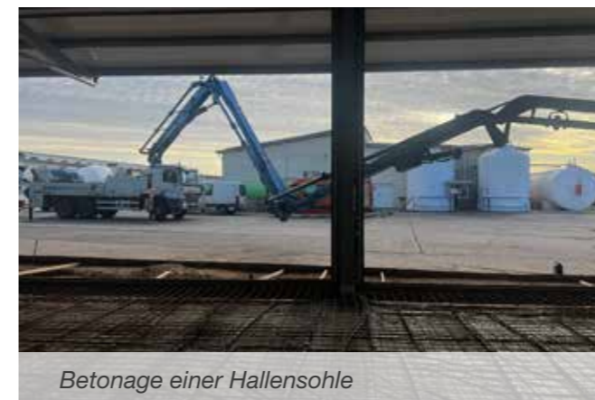
Mischwerk Güte Beton, Hagenow
